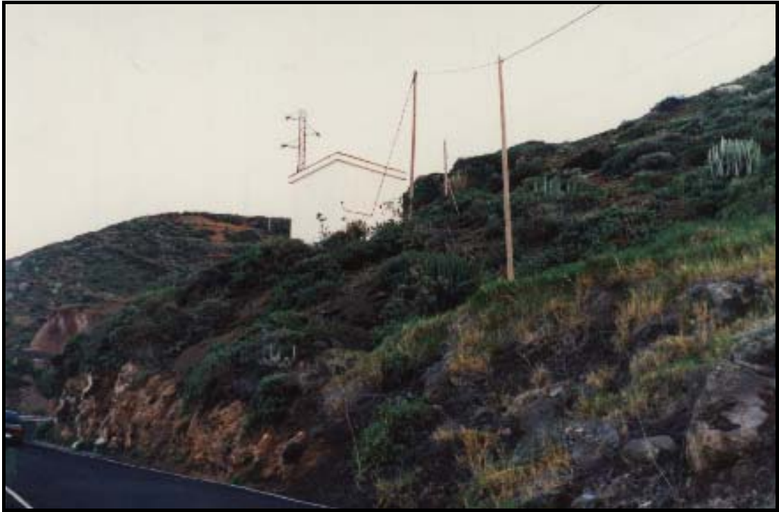
- Estación transformadora existente.
