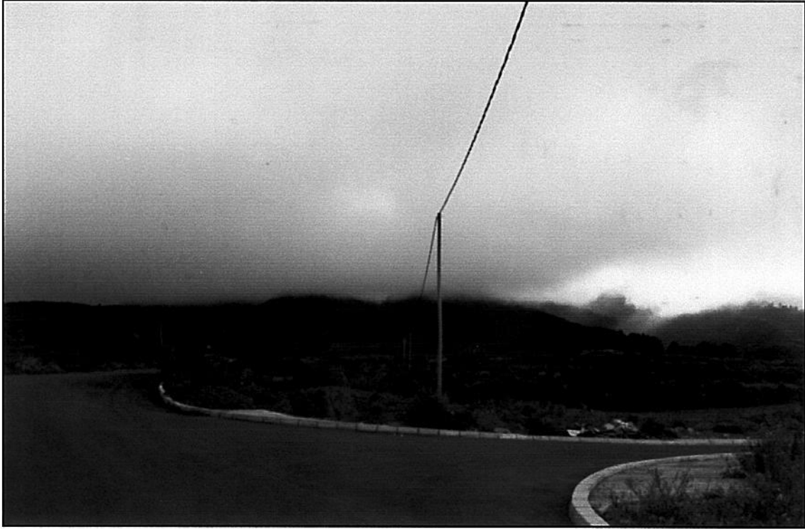
- TENDIDO AEREO DE BAJA TENSION QUE PASA POR EL SECTOR
