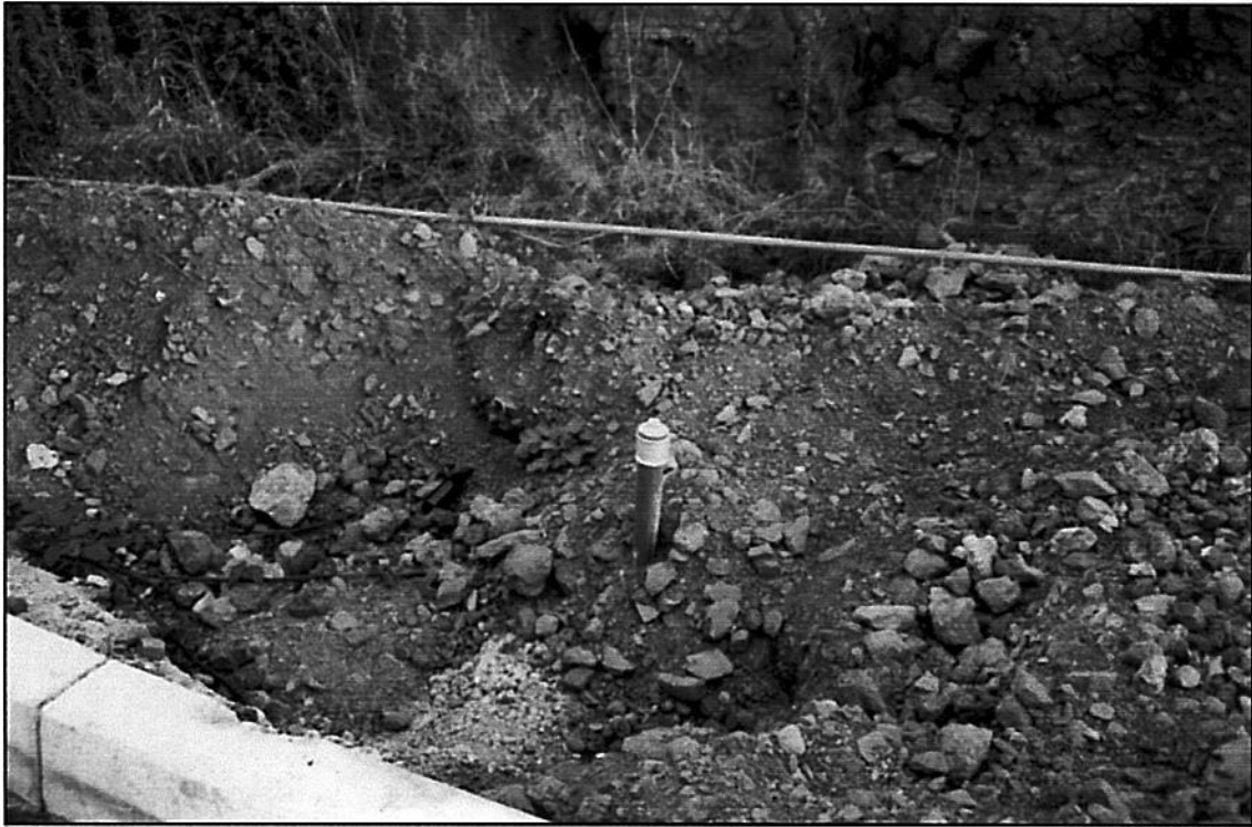
- BOCA DE RIEGO
