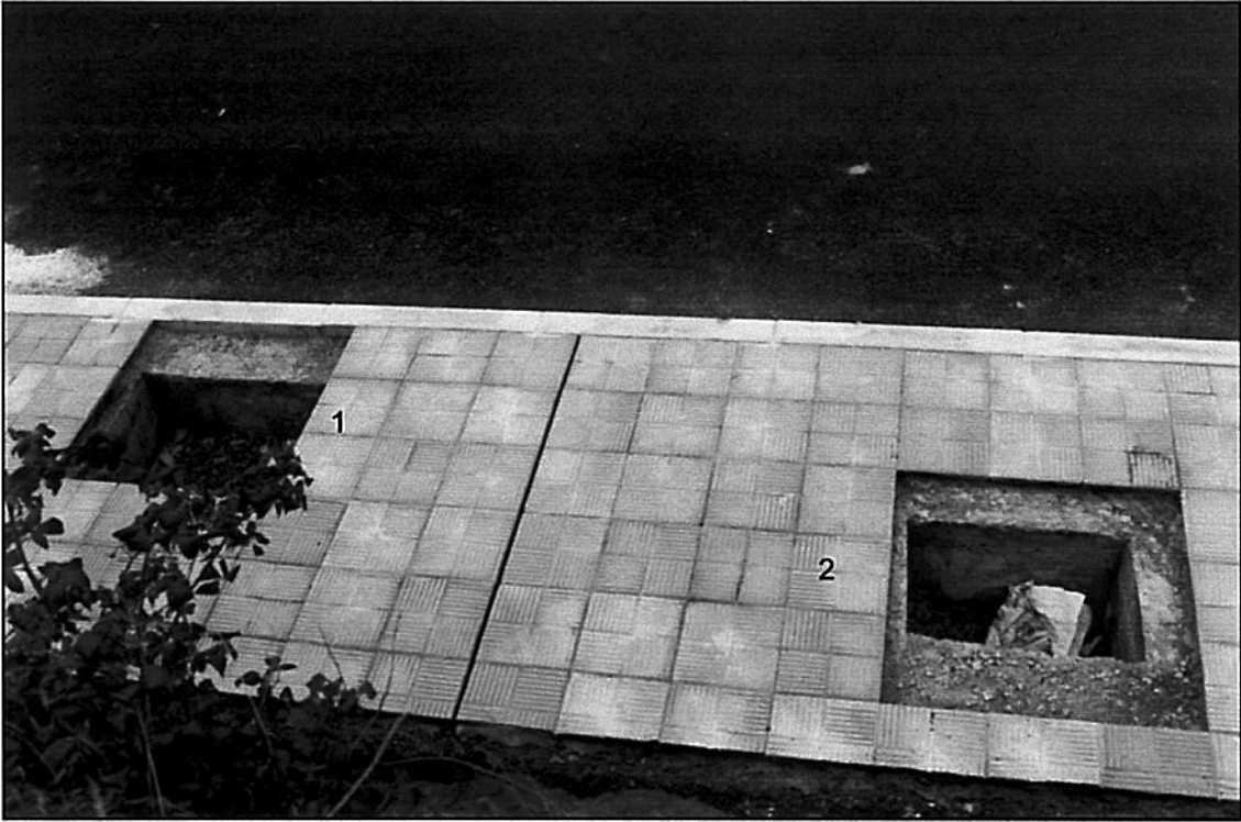
- ARQUETAS DE TELEFONIA (1) Y RED DE BAJA TENSION (2)
