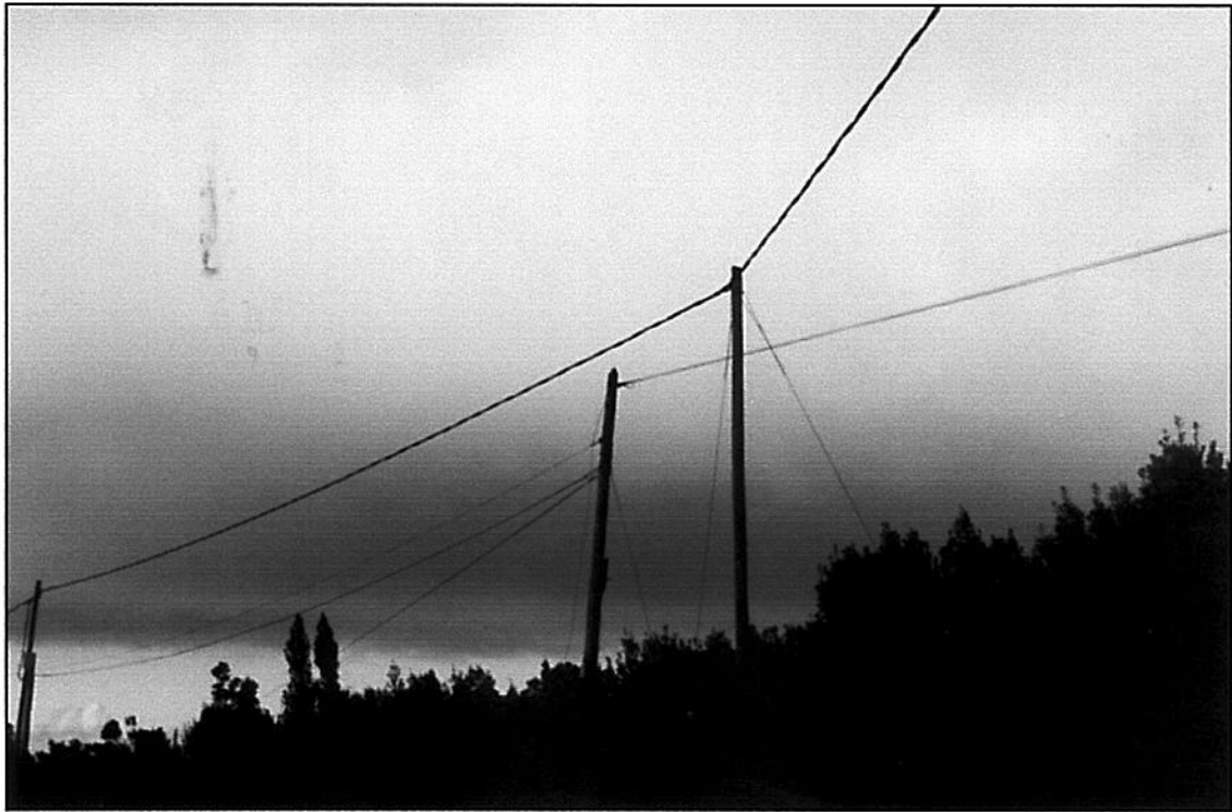
- TENDIDOS AEREOS DE TELEFONIA Y BAJA TENSION
